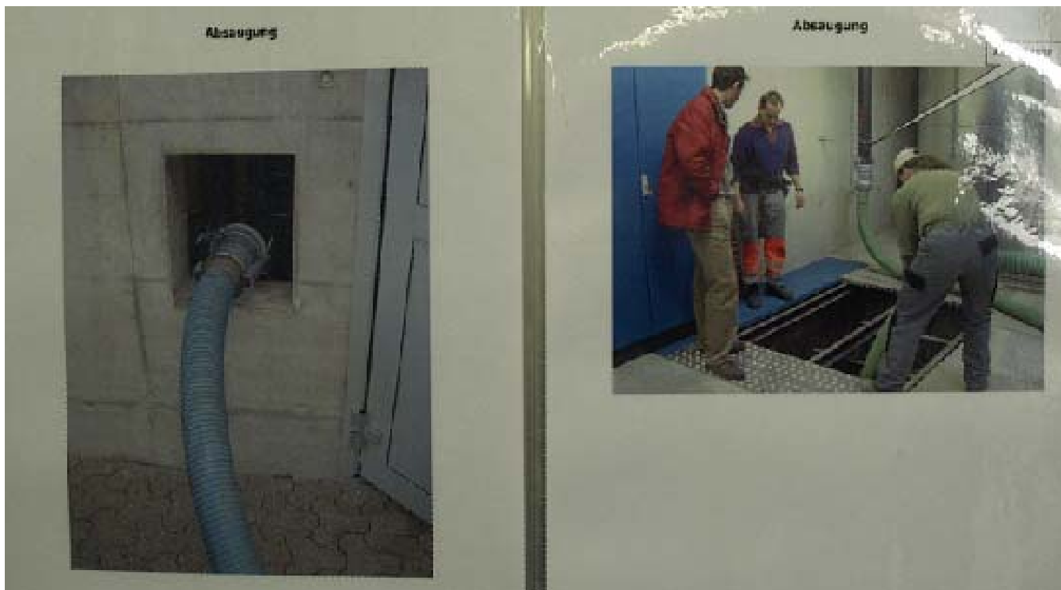
Centrale di Sumiswald, sistema di evacuazione della cenere (aspirazione)
