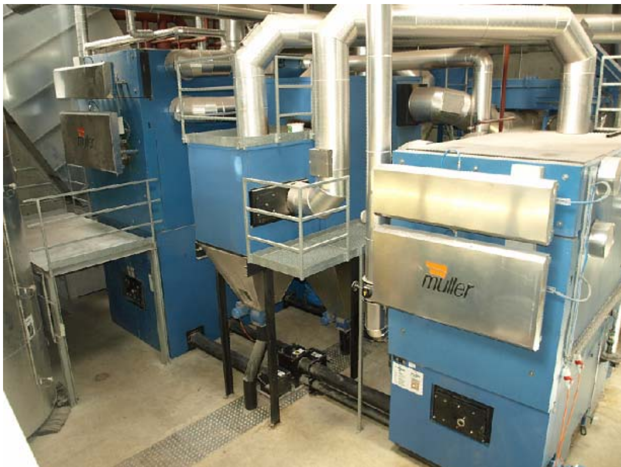
Centrale di Sumiswald, caldaie di 3 e 1 MW
